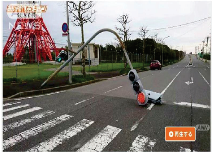
信号柱の倒壊
